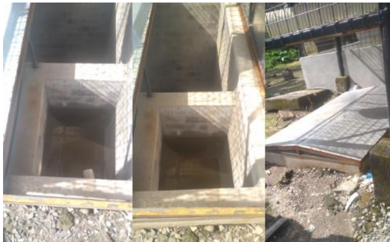
Figura 4.3 Pozo de reciclaje
